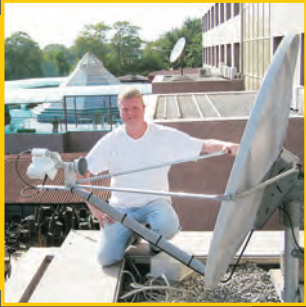
Installation bei der Deutschen Botschaft in Turkmenistan-Aschgabat (20km in Grenz-nähe zum Iran)
